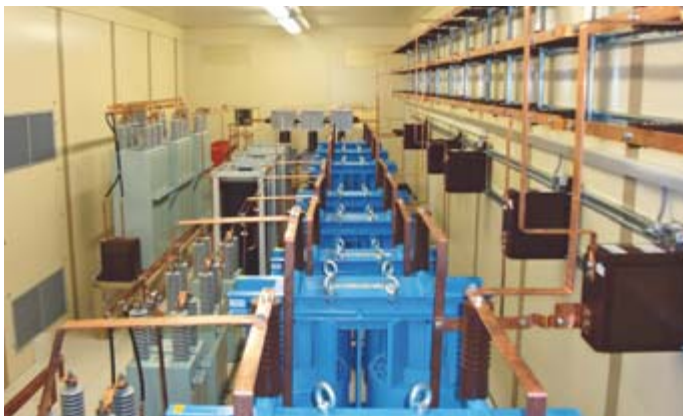
Mittelspannungs-/Filterkreisanlage im Schaltheischausmodul
