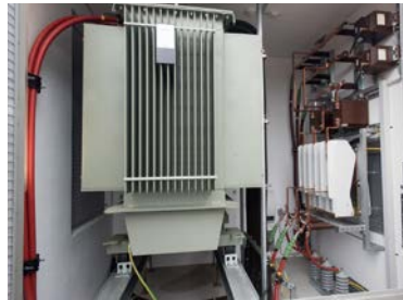
Step Up-Trafo zum Anheben der Spannung von 690 V auf 30 kV für den dynamischen Teil der Anlage.
