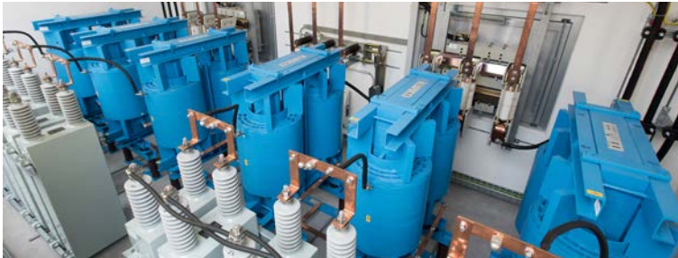
Blick in den MS-Teil der Hybridanlage mit den Drosseln (blau) und MS-Kondensatoren im Vordergrund.
