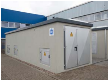
Die zwei gelieferten Hybridanlagen in Form von Betonstationen für entsprechende Sicherheit.
