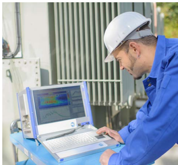
Messgerät im Einsatz
